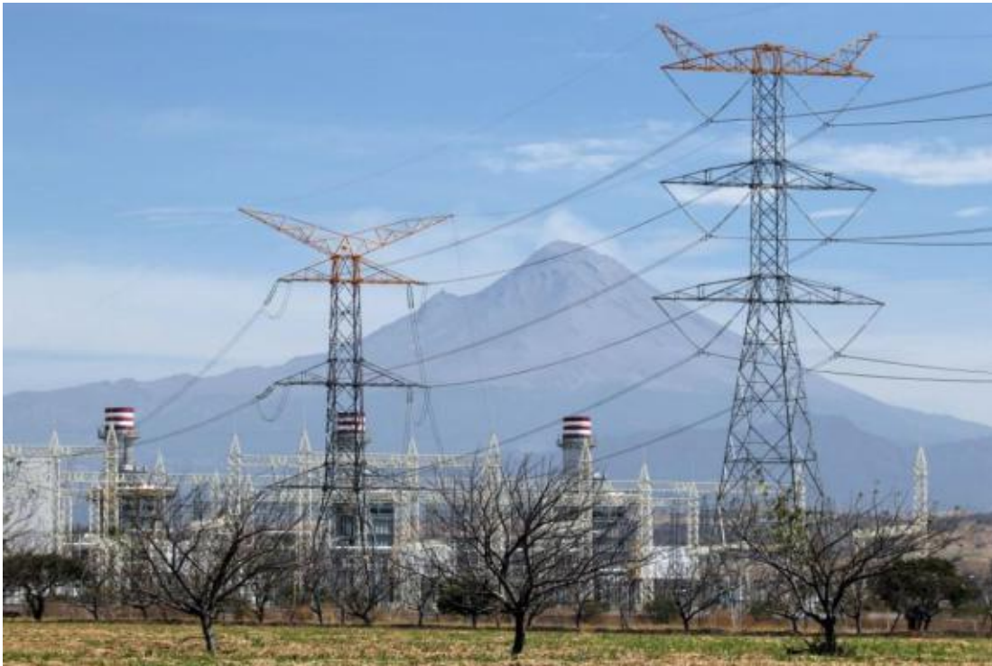
Termoeléctrica de ciclo combinado, en Huesca, Morelos.
